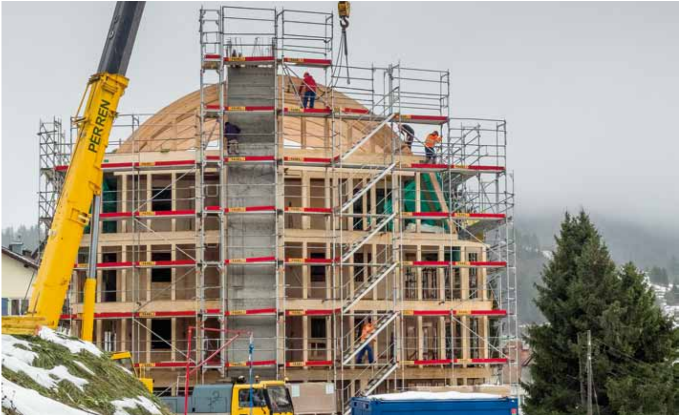
Montage des Westgiebels. In der Mitte: Liftschacht mit Nistkästen für Mauersegler und Unterschlupf für Fledermäuse. Alle Fotos: © DomaHabitare
